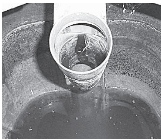
槽本体から漏水の写真
