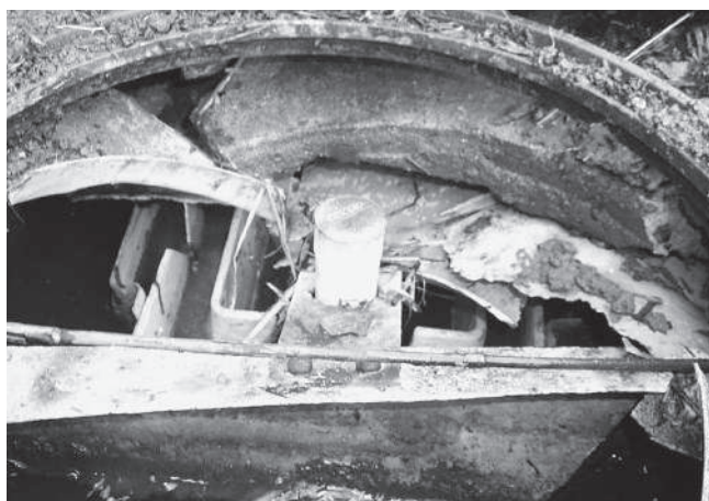
槽本体が著しく破損の写真
