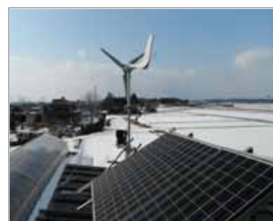
太陽光パネルと風力発電装置 の設置状況
