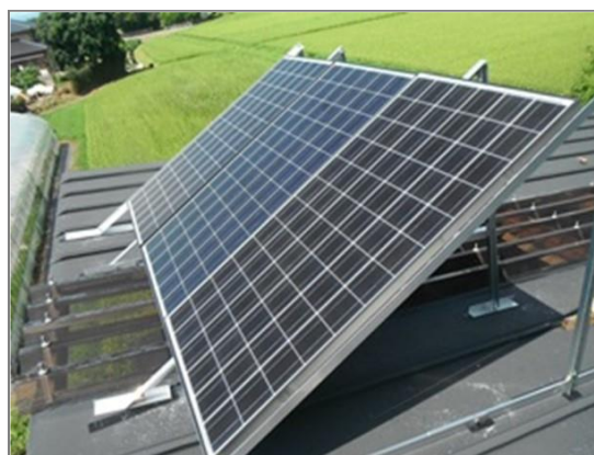
写真-1 太陽光パネルの設置状況
