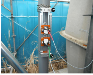
写真1 流量計の設置
