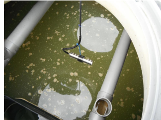
写真2 濁度計設置(嫌気ろ床槽)
