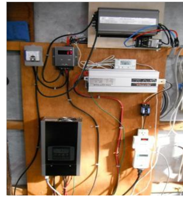
写真-4 小型風力発電用充電コントローラー等の設置状況
