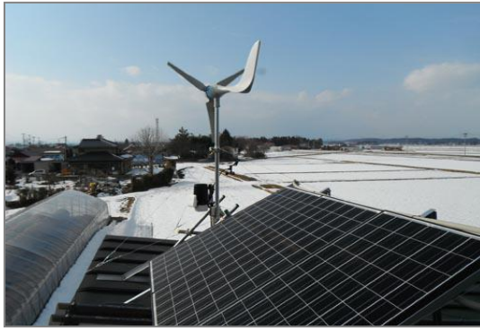
写真-3 太陽光パネルと風力発電装置の設置状況
