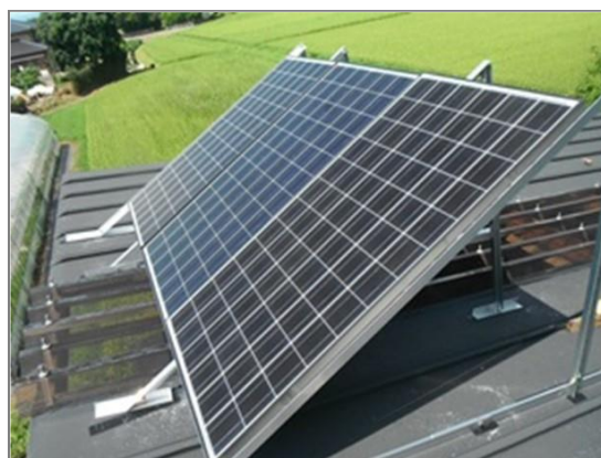
写真-1 太陽光パネルの設置状況
